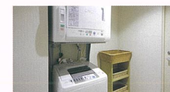
ランドリーコーナー 洗濯機と乾燥機を設置しております。連泊でも衣類の心配がありません。
